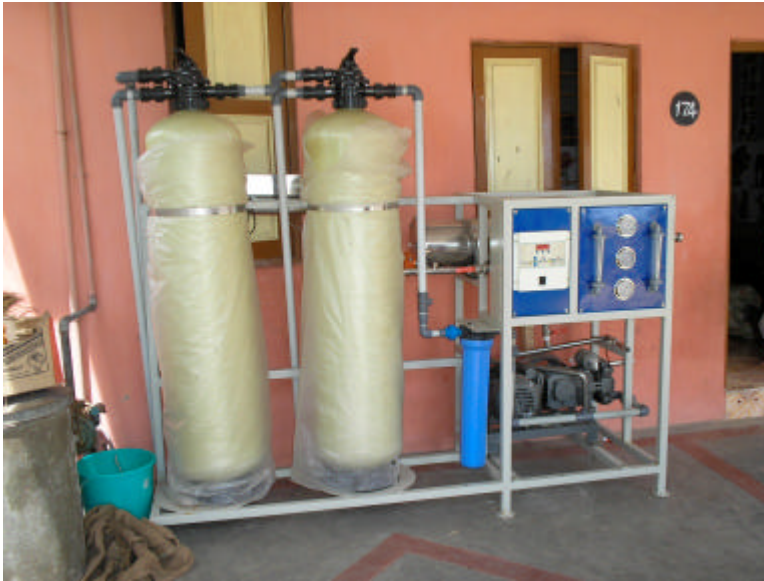
Reverse Osmosis Water treatment plant Osmose-Wasseraufbereitungsanlage
